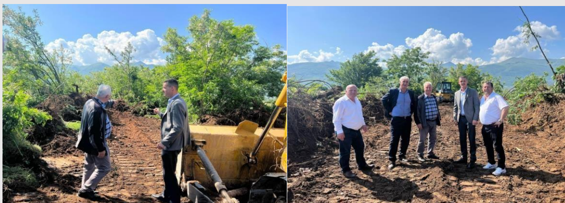
Gjatë realizimit të projektit “Ndërtimi i infrastrukturës rrugore në Bujqësi dhe Pylltari” vranëq
