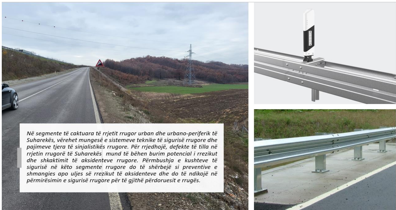
Fig.14. Mungesa e sistemeve teknike të sigurisë rrugore
